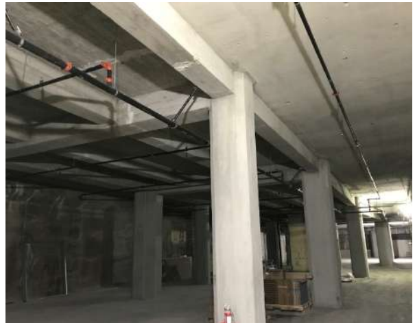
Metro Fire Suppression
